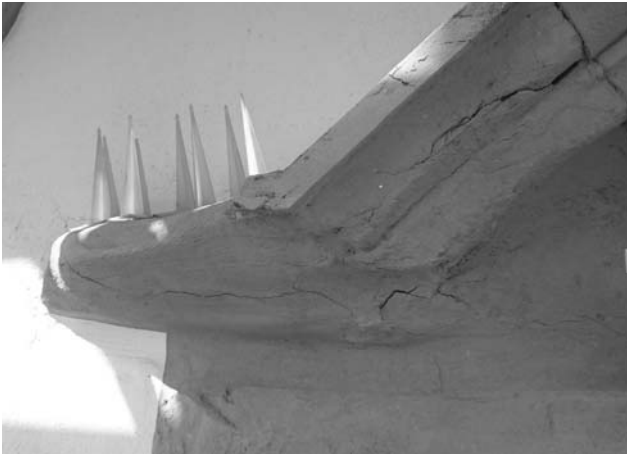
Stark rissige und nicht formgerechte alte Antragung
