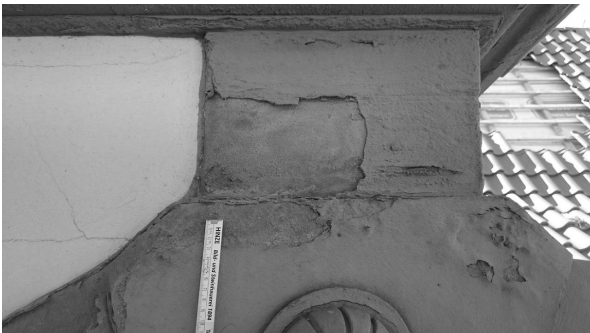
Großflächiges Aufblättern, Blasenbildung und Schichtspaltung an Rotsandstein
