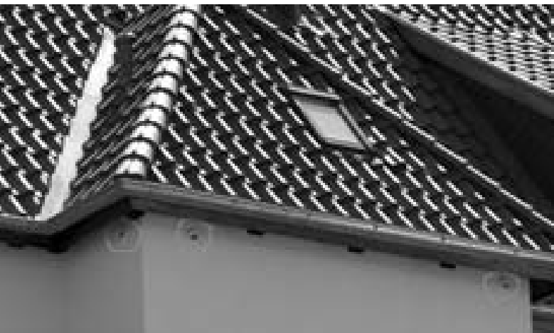
Hier sind nur noch die Einfluglöcher direkt unter dem Dach, also dort, wo Mauersegler am liebsten anfliegen, zu sehen. Die Kästen sind in die Wärmedämmung integriert.
